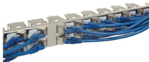
D. Moduły Keystone zamontowane w chromowym patch panelu
